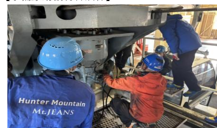
【予備原動機切替訓練】
